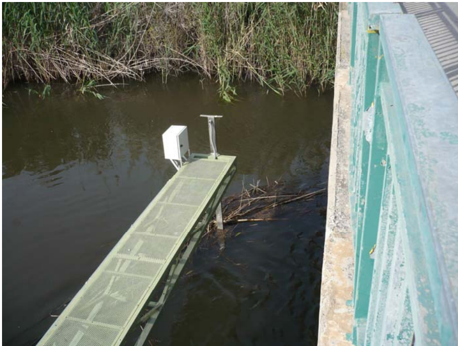
Figura 20.- Telemetida instalada en la sección de aforos del río Racons-Molinell
